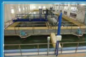
Míchání a usazovací nádrže na úpravně vody U Sv. Trojice v Kutné Hoře
